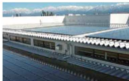
▲本社工場屋上の太陽光パネル
